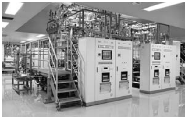
高崎工場・バイオ医薬原薬製造設備 精製室
