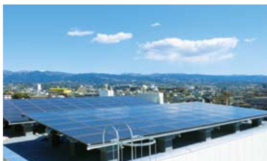
富士工場の太陽光発電設備
